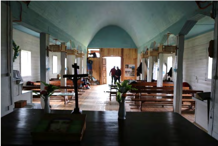
Imagen 9.- Inicio de la segunda etapa, destape de los vanos, 2018. Fuente: María Paz Salvadores.
