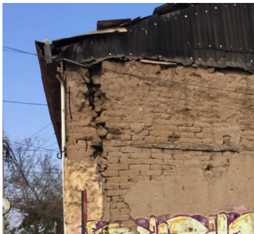
Imagen 5: Daños en encuentro de esquina en un inmueble del siglo XIX en el casco histórico de La Serena
