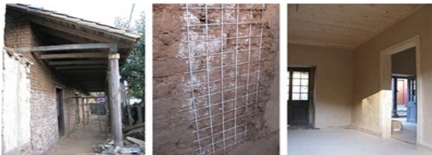
Imagen 6: Malla electrosoldada como refuerzo en muros de adobe, en Vichuquén, en el marco del terremoto de 2010
