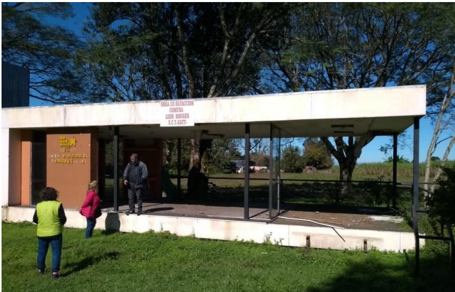
Figura 14: Módulo CITCI luego del impacto de la tormenta. Fotografías del Autor.
