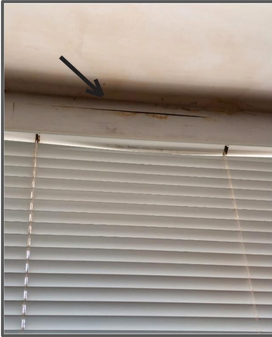
Figura 10. Daños estructurales del espacio de repositorio del CRILaR. La flecha señala sector con manchas de humedad por filtración de agua y grieta en el revestimiento de la pared, por encima de una ventana. (Fotografía: R. C. Spano).
