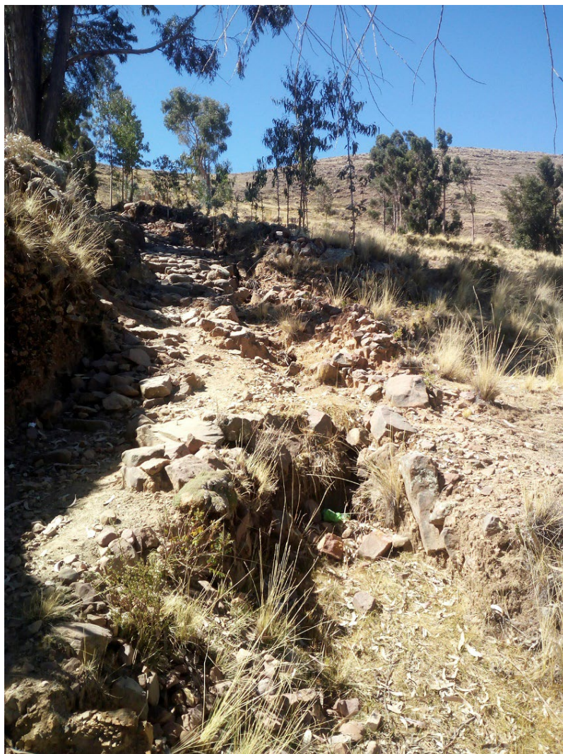
Figura 3. Estado del camino prehispánico antes de su intervención. Se puede denotar la caída de los muros de contención, el desprendimiento de bloques líticos de la calzada, y afectación por bioturbación.
