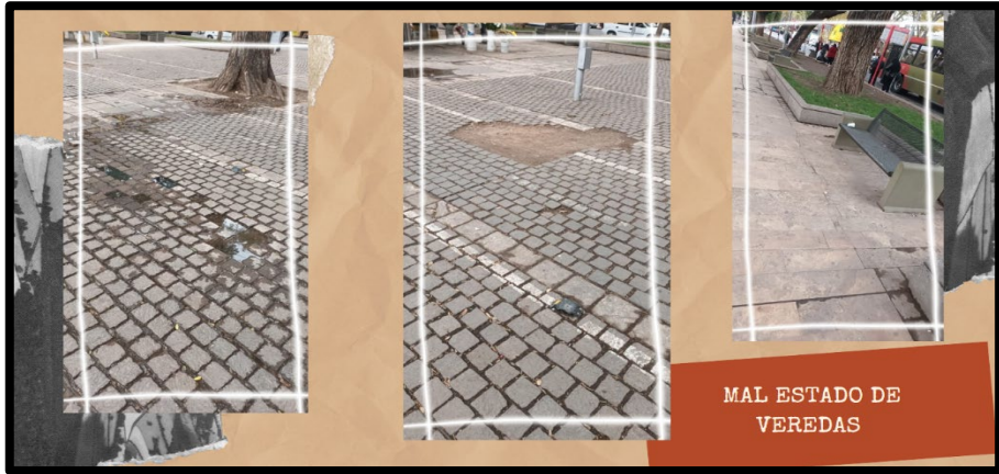
Figura 3. Infraestructura urbana deteriorada en Paseo Alameda 1 . Fuente: archivo fotográfico de la autora.
