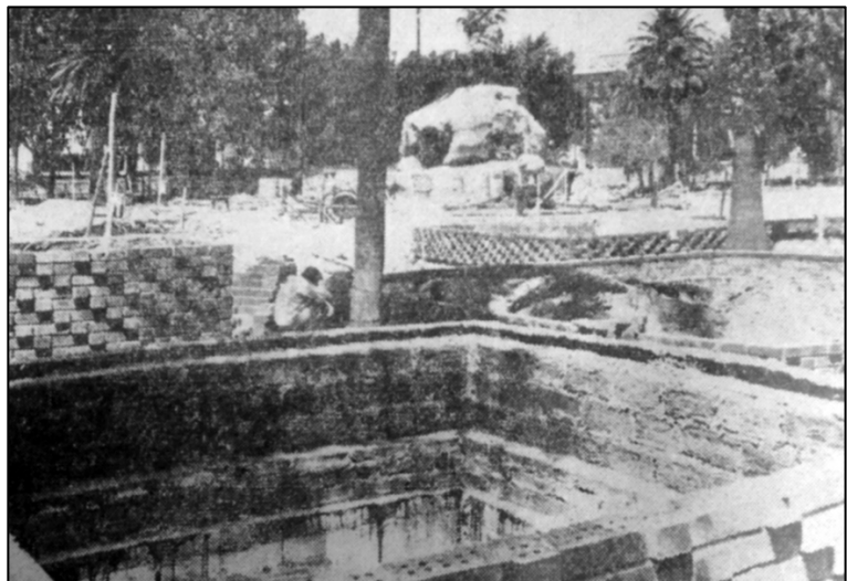
Fig. 4: Trabajos de remodelación de la Plaza San Martín hacia 1969. Puede distinguirse en primer plano la construcción del estanque, en
