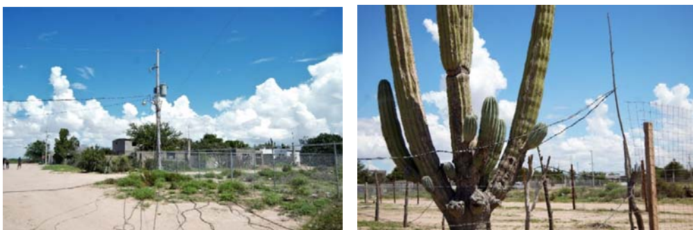
Fig. N° 4a y 4b. Suministro improvisado de energía eléctrica en la Colonia Mediterráneo
